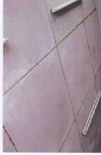
Controsoffitto con pannelli contenenti amianto
