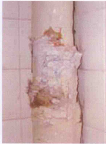
Tubazione con coibentazione in amianto
