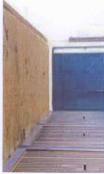
Soffitto intonacato con amianto
