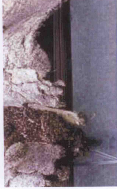
Particolare di lastra in cemento-amianto degradata
