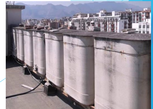
Serbatoi di acqua
