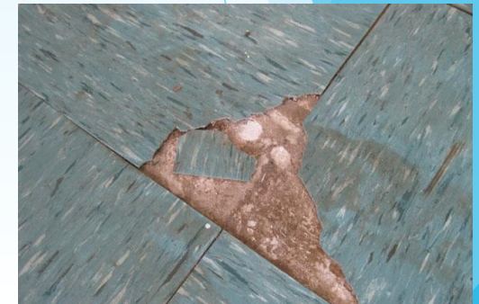
Pavimenti in vinil-amianto
