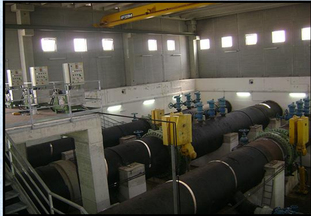
Impianto acquedottistico di Napoli
