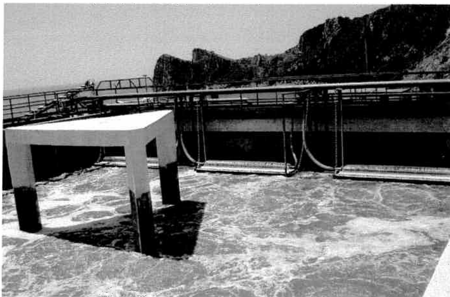
Figura 1 Riempimento del reattore biologico (si notano i moduli delle membrane polimeriche in via di sommersione)
