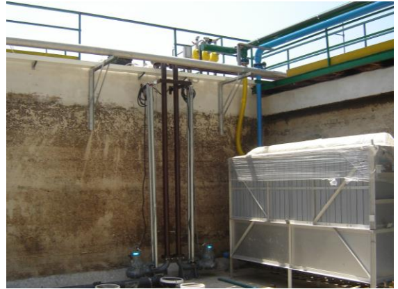
Figura 6 Modulo MBR nel reattore biologico vuoto
