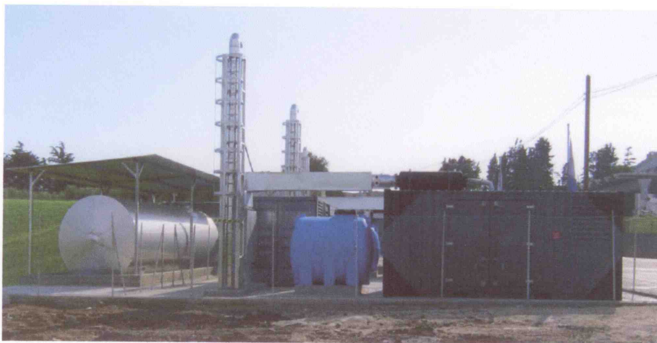
“Impianto da 1Mwe”
